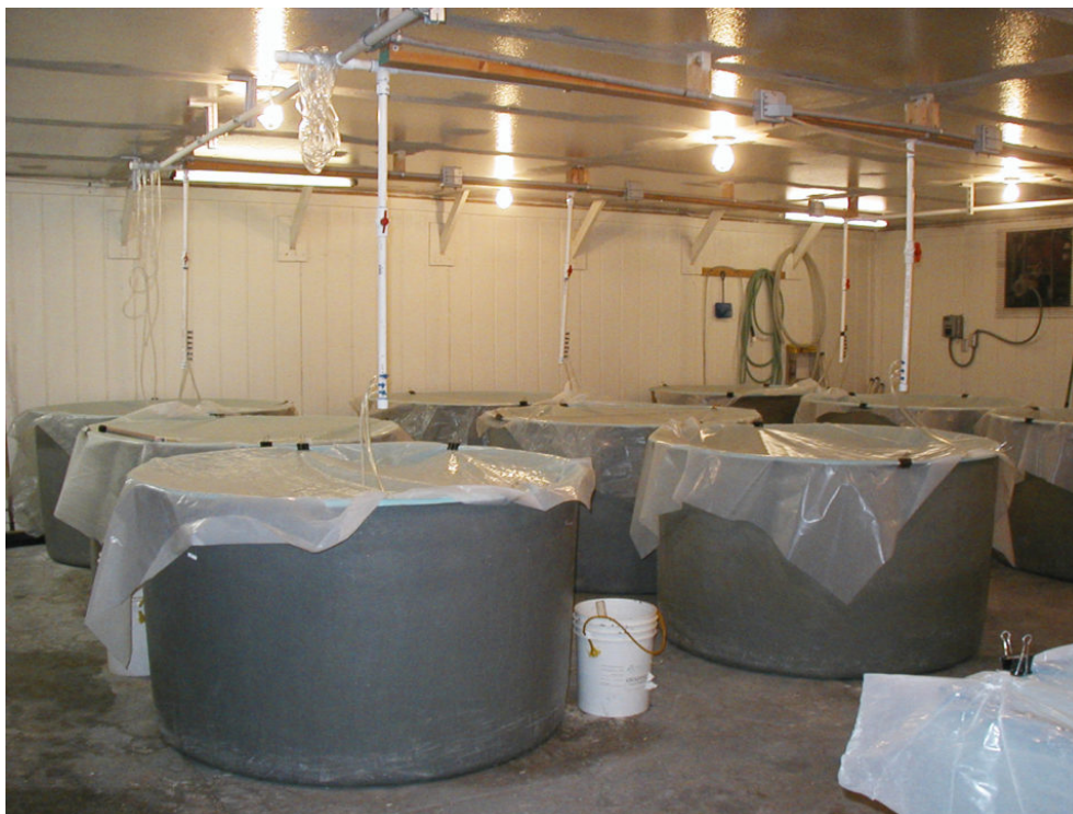
Fig. 2: Vista AQ del interior de la instalación de cuarentena primaria.
